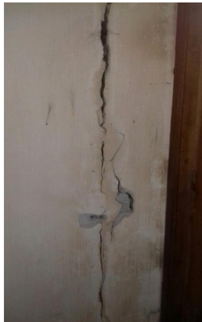
Рис. 7- тріщина в стіні
