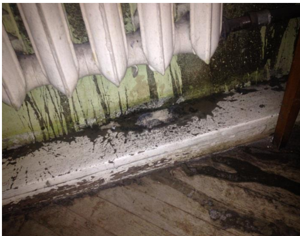
Рис. 5,6- батареї в корпусі №2
